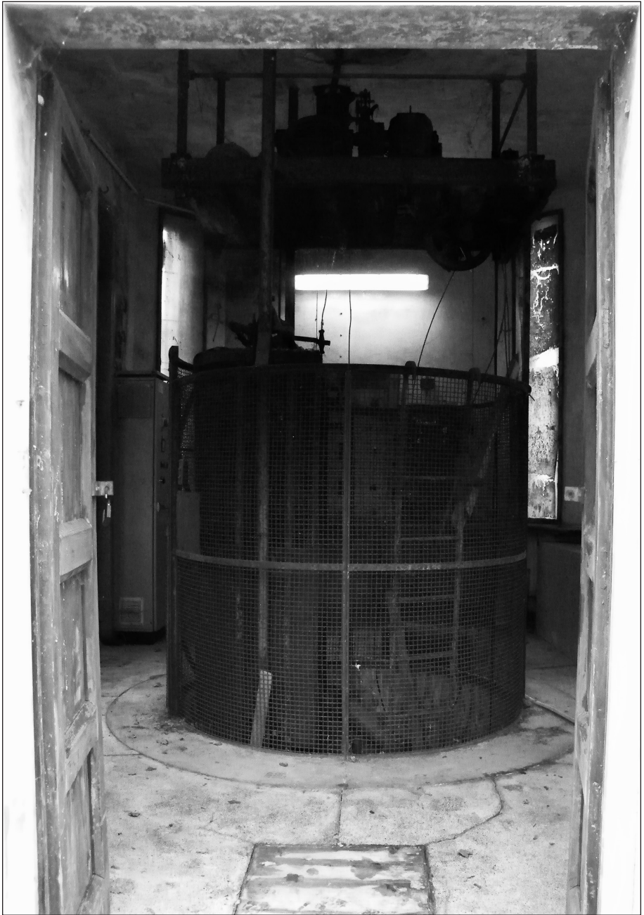
Ascensore per accedere al vano pompe (Foto Laurini Ettore)
